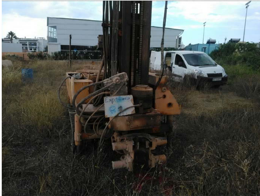
Foto 1: Emplazamiento de sonda en punto P 1
