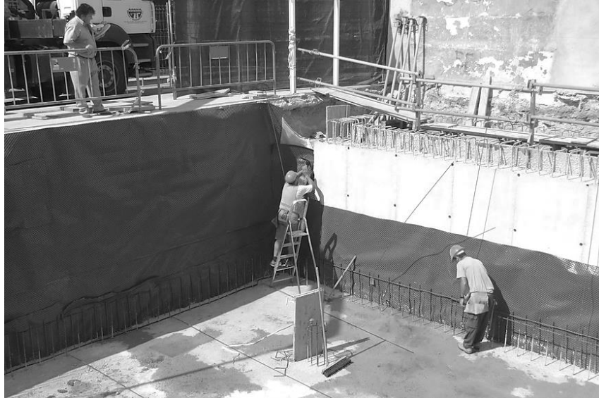
Muros de sótano en la Biblioteca infantil, en San Vicente del Raspeig. Alicante.
